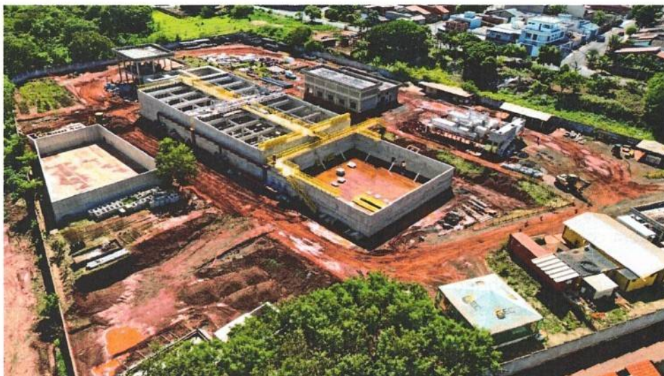
Figura 13 – Vista aérea da ETE Tijuco Preto.
