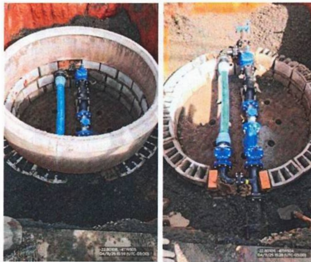
Figura 10 - Macromedidor Maria Antônia.
