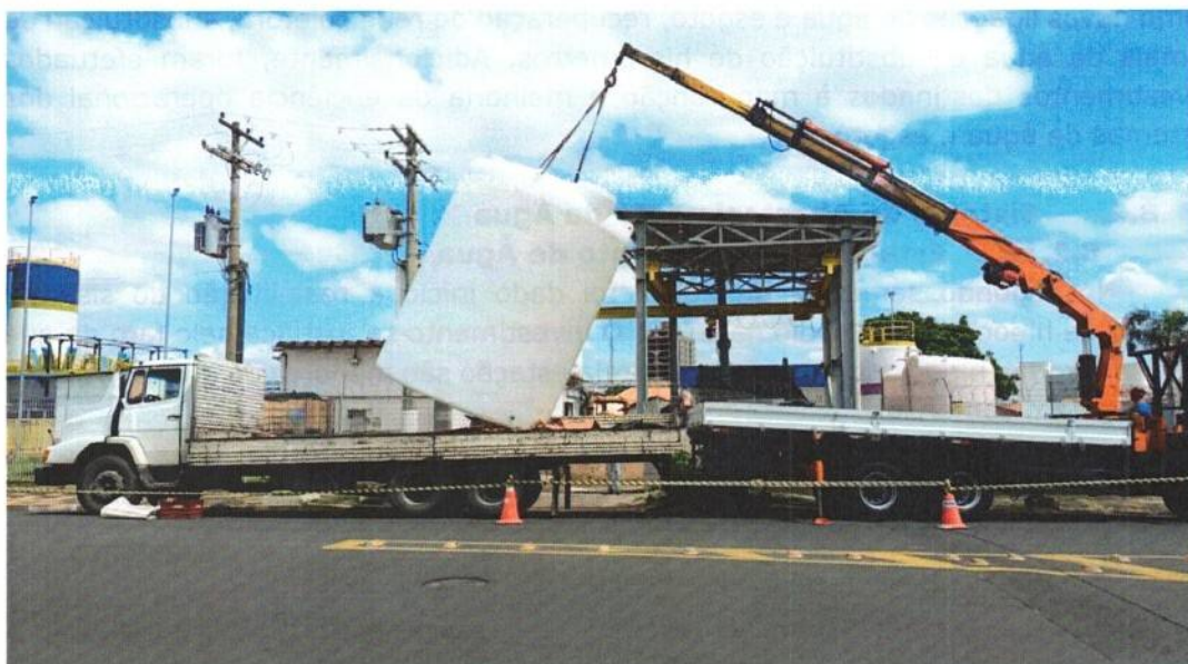
Figura 2 - Tanque para armazenamento de hipoclorito de sódio.
