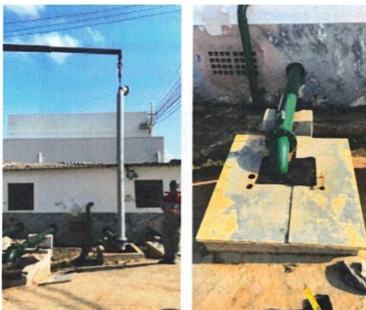
Figura 4 - Crivos de sucção das bombas 1 e 2 - ETA 1 x Veccon.
