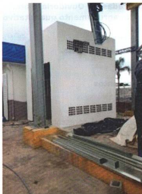
Figura 1 - Sala de painéis do sistema gerador de hipoclorito.
