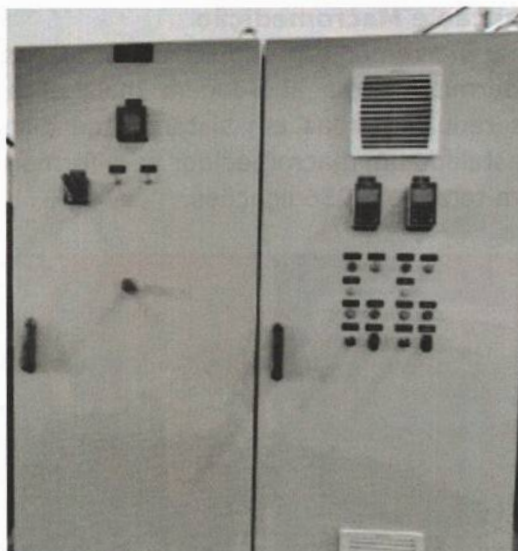
Figura 11 - Painel de comando CR San Martin.
